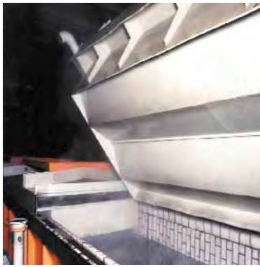
Abb. 1: Beizbehälter für Normalstähle mit hochgeklappter Abdeckung
