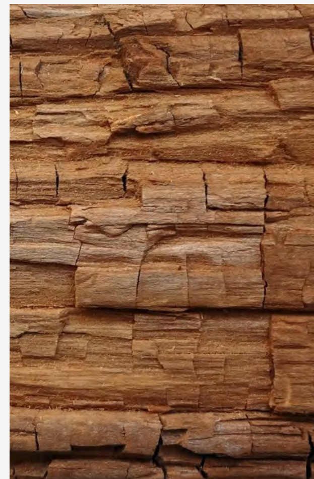
Typisches Schadbild „ Würfelbruch “
